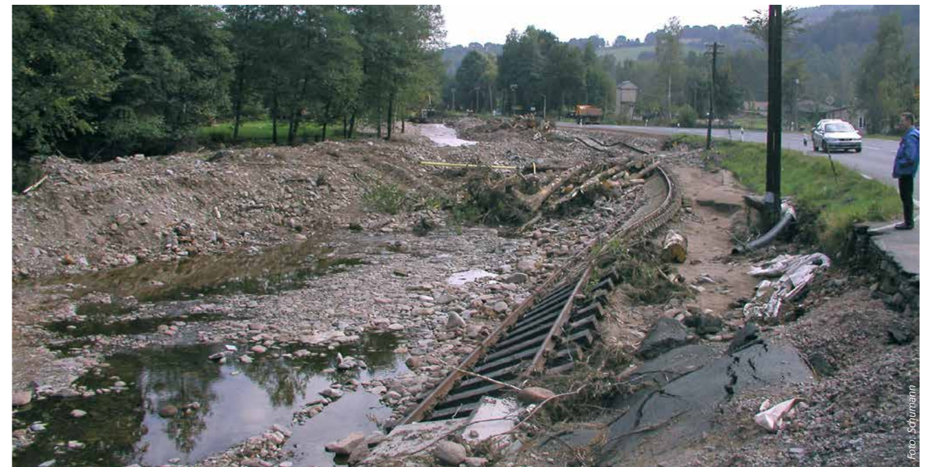
Verheerende Hochwasserschäden: Das Gleisbett der Müglitztalbahn im Osterzgebirge wurde 2002 nicht zum ersten Mal komplett zerstört.
